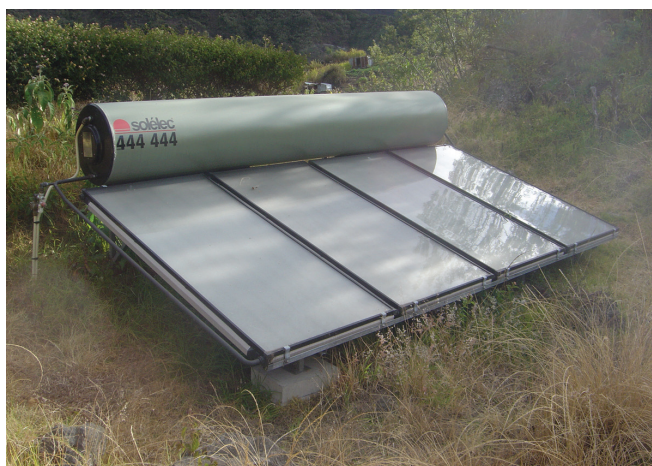
Calentador de agua con energía solar
